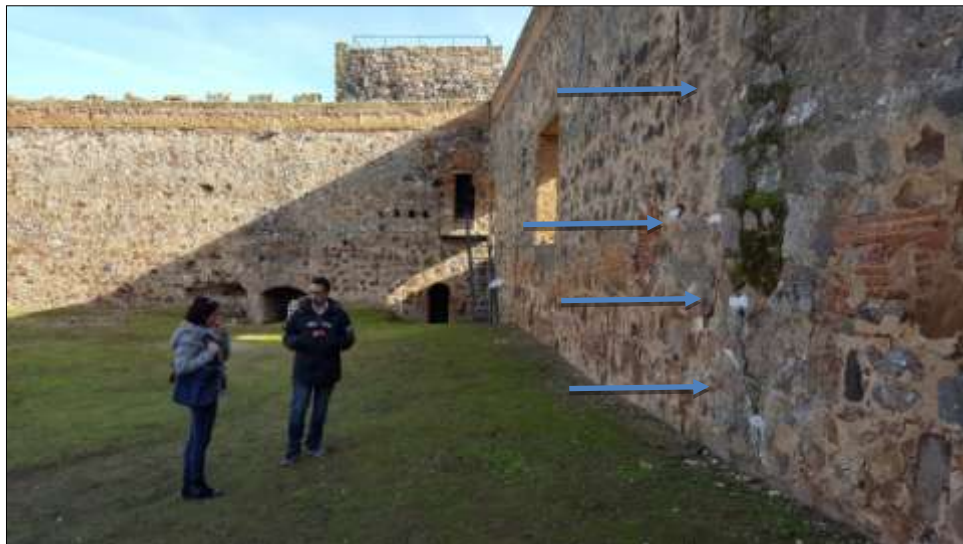
Zona de actuación arqueológica 1000 y grieta en el lienzo.
